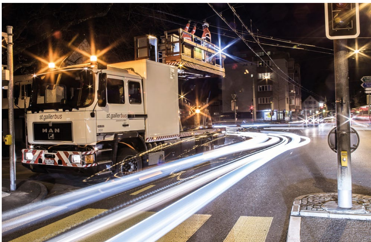
Aménagement de la ligne de contact – bus de la ville de St-Gall Source: Transports urbains st-gallois
